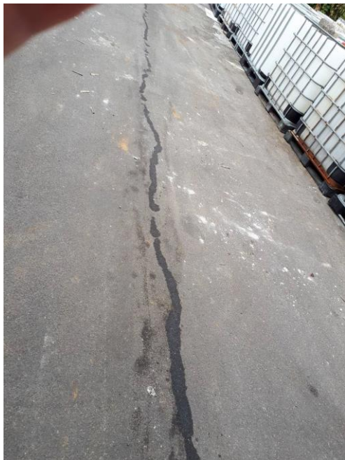
Oliespild på asfalt i gården
