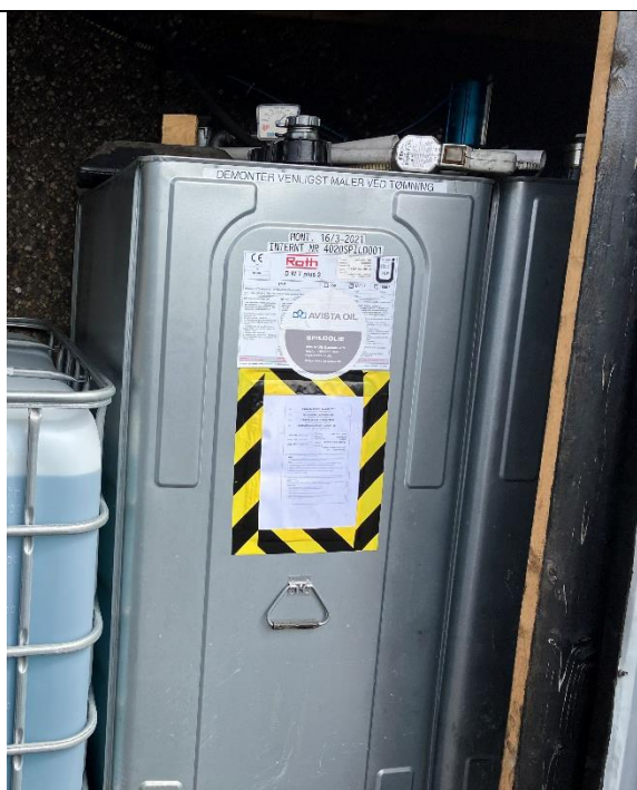
Spildolie i dobbeltvægget tank
