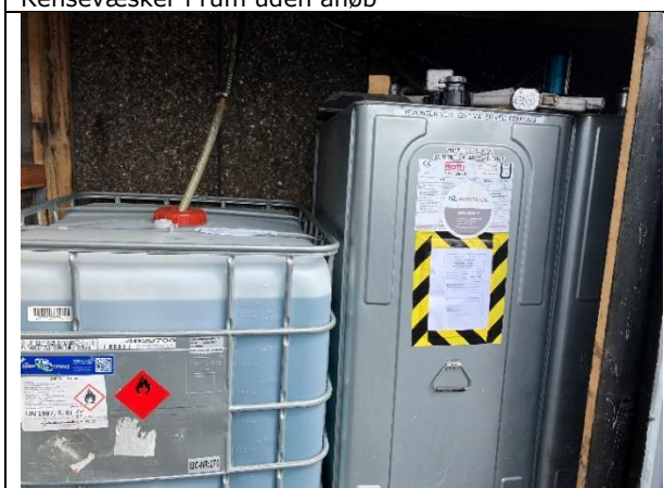
Sprinklervæske i skur, der aftappes indendørs. Ren olie er placeret i samme skur i dobbeltvæggede tanke og aftappes også indendørs
