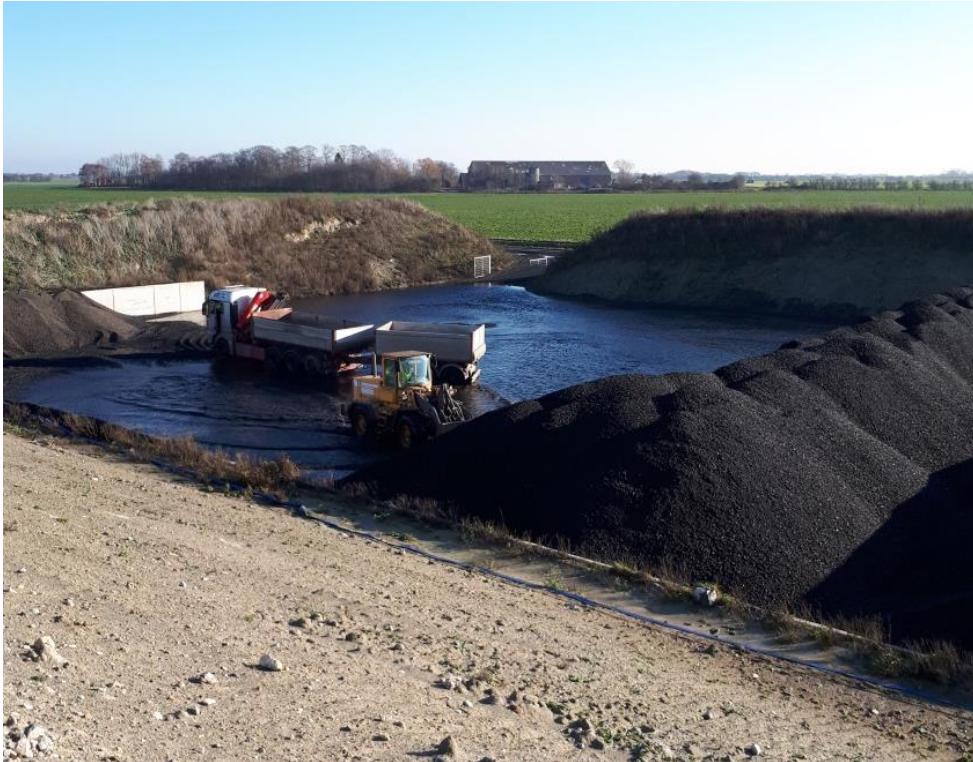
Foto 5. Slukningsvand opstaves og nødvendiggør dræning
