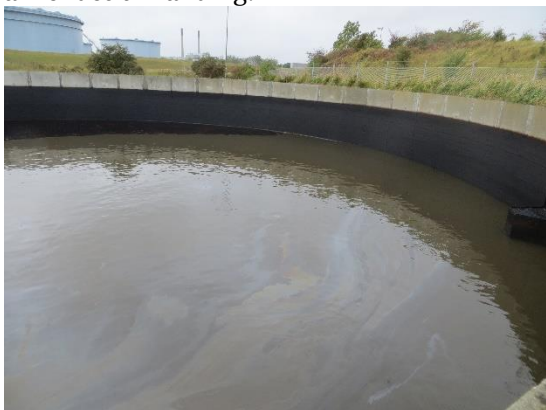
Perkolattank på matrikel 8c der opsamler overfladevand fra nye slamplads. Der ses tydeligt olie på overfladen.
