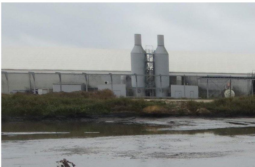
Luftreanseanlæg (to skrubbertårne) monteret på telthallen på den sydlige del af den nye slamplads.
