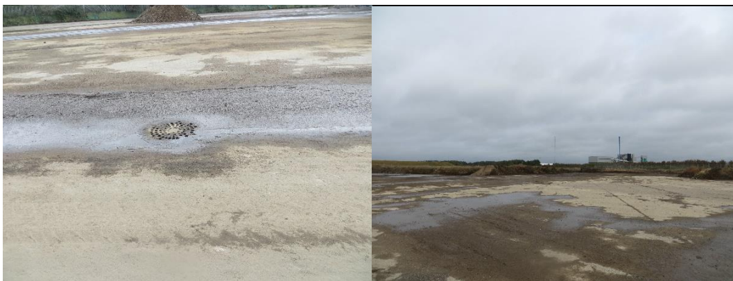
Belægning på den nye plads. Til venstre tydelig slidtage og til højre ses en revner.
