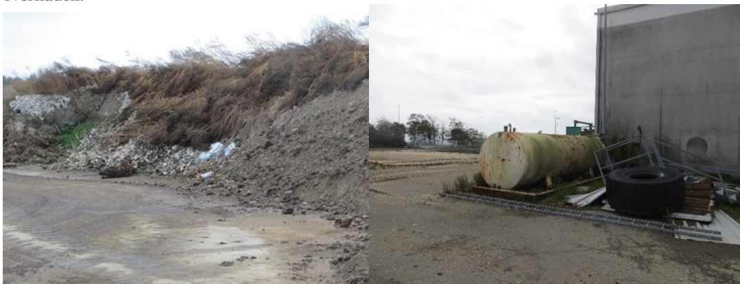
På foto til venstre ses en del byggeaffald i den del af jordvolden der omkranser anlægget. Volden er en del af anlægskonstruktionen. Til højre ses en olietank i ringe stand ved telthallen.
