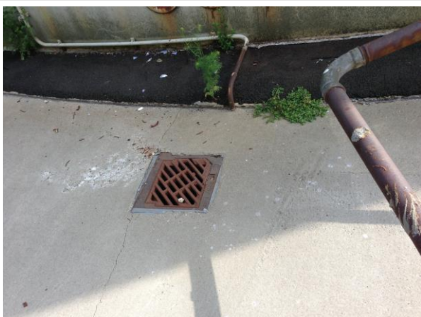
En af sivebrøndene ved T106
