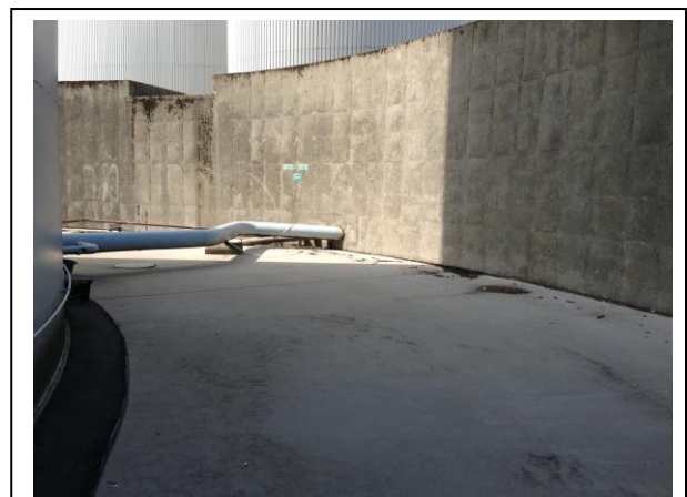
Belægningen i tankgård ved T106
