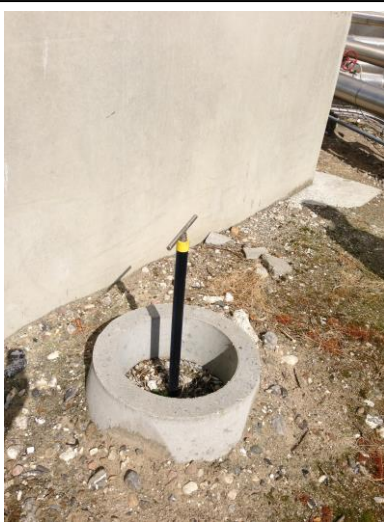
Tankgårdsventiler tilknyttet alle tankgårde.
