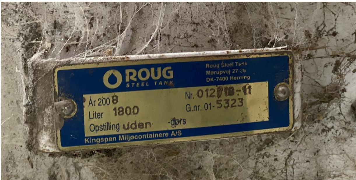
Olietank med manglende oplysninger.
