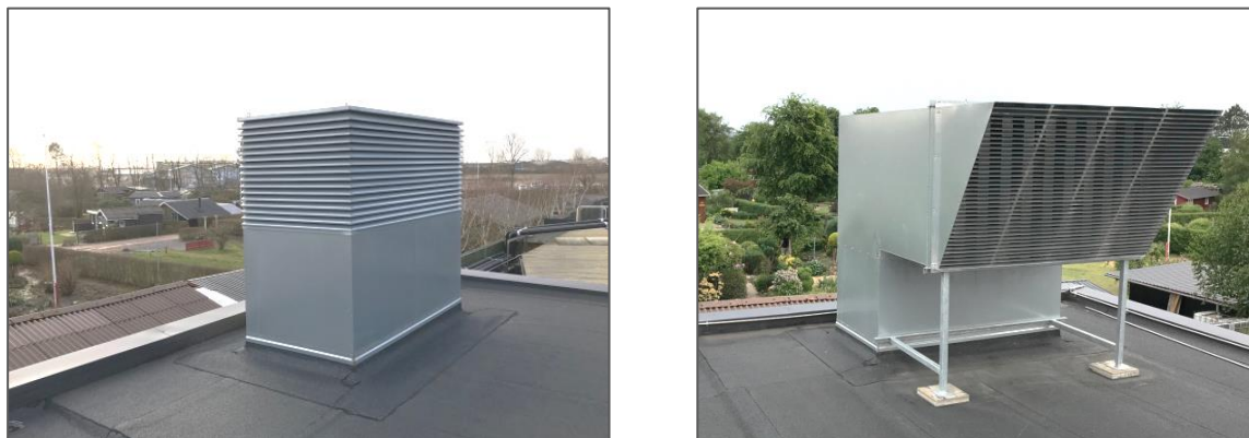
Figur 5 Venstre foto viser afkast på tag af gasmotorhus før dæmpning (25-01-2018). Højre foto viser afkastet efter foretaget dæmpning (29-05-2018).
