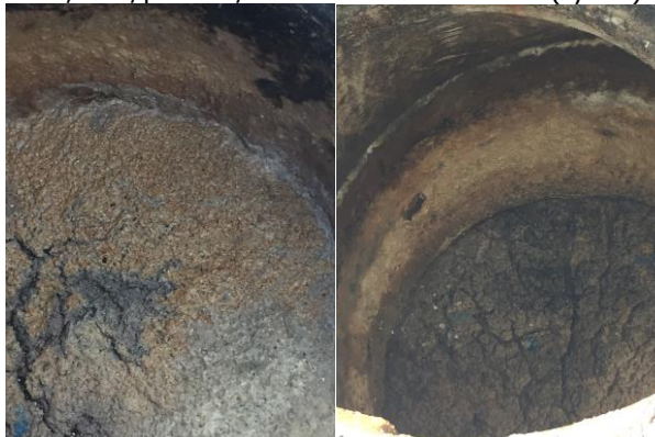
Figur 1 Overfladen i slamfang og fedtudskiller inden tømning - foto fra tilsyn den 17.5.2024.
