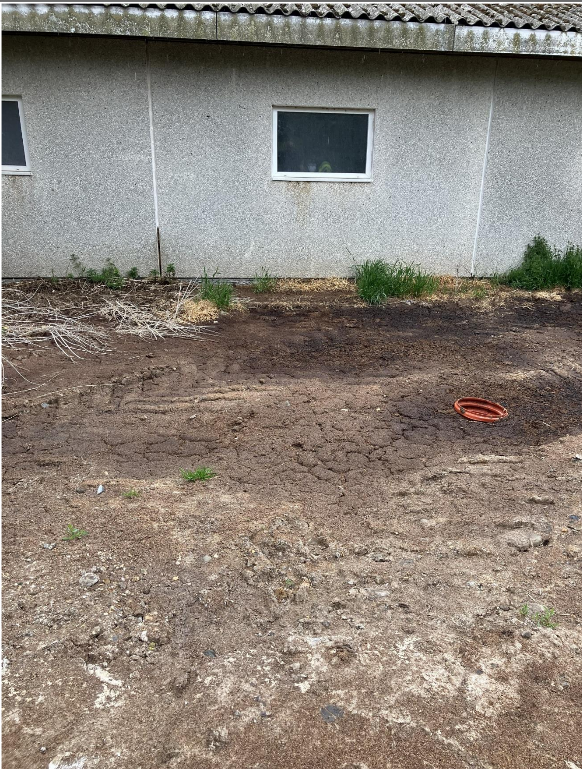
Øvrige bemærkninger, manglende afløb på vaskeplads
