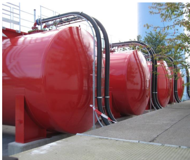
4 x 100 m 3 dobbeltvægede tanke med gangbro
