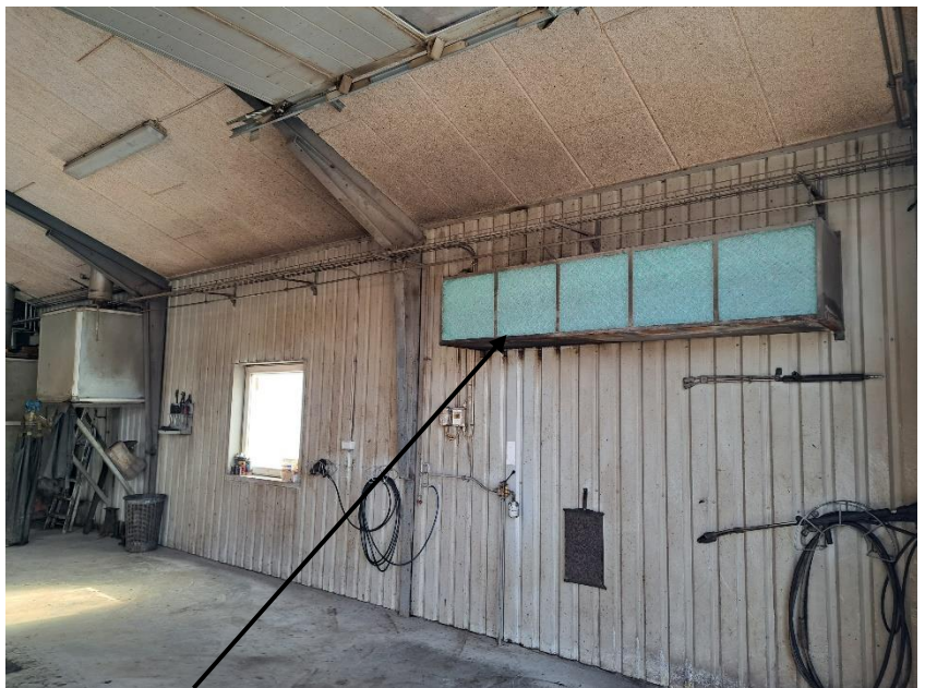
Billede nr. 8: Filter ved vaskeplads. (2023)
