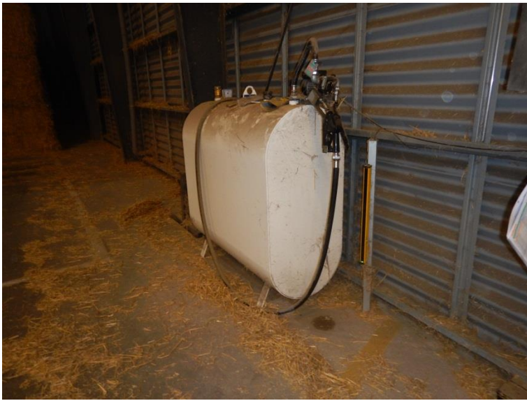
12. Tank med dieselolie.
