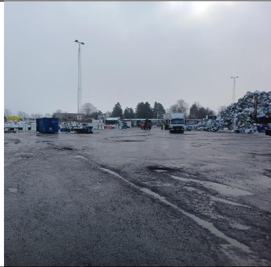
Foto 9: Oplagspladsen ved siden af hallerne mod vest. Oplag af kølemøbler og hårde hvidevarer. Her ses belægning med manglende vedligehold.
