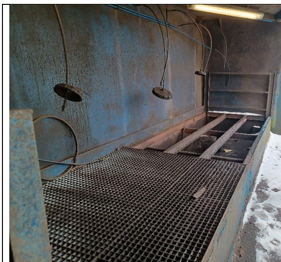
Foto 6: Spildbakke under halvtag, tømt for olieholdige pallettanke mv.
