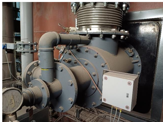
Figur 8 Ny etableret opstartsbrænder oven 2
