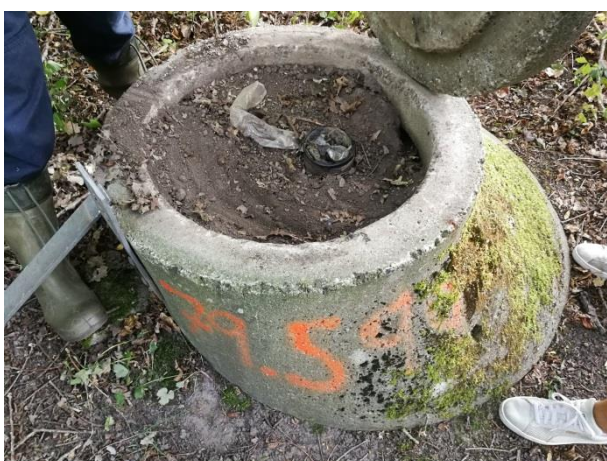
Jordfyldt beskyttelsesbrønd med forerør tætnet med plastpose i forerøret
