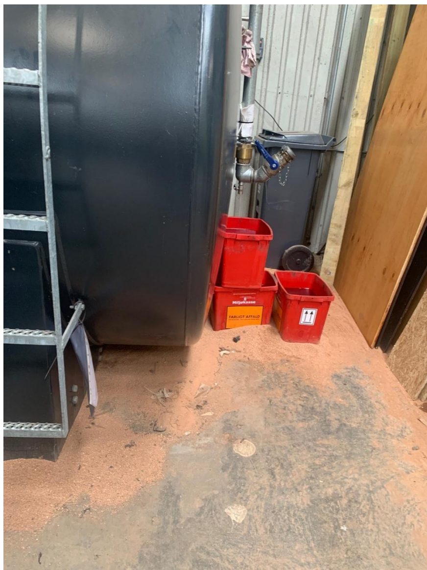
Foto 3 Dieselloletankens påfyldningsstuds er utæt.
