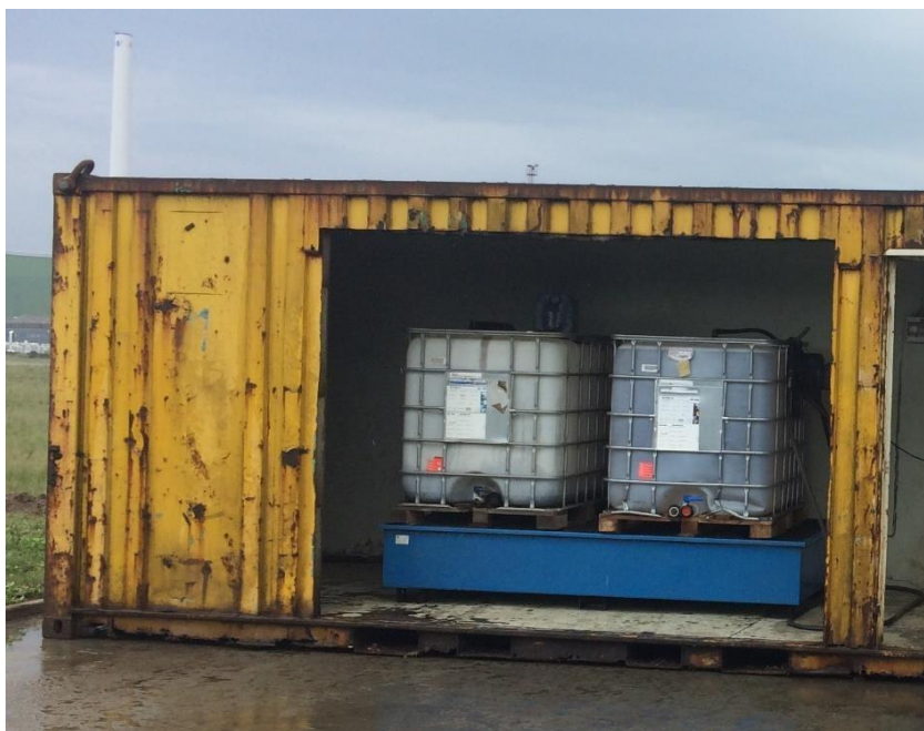
Figur 2 Spildolietank og hydraulikolietank i container på spildbakke.
