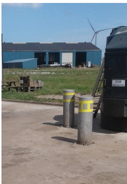
Figur 1 Brændstoftank med afspærring
