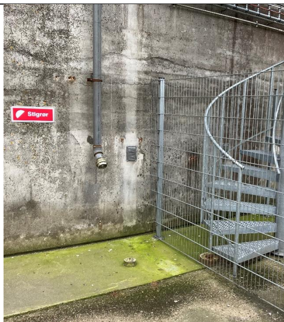
Foto 2: Stigrør til fremføring af slukningsvand til lager 8.
