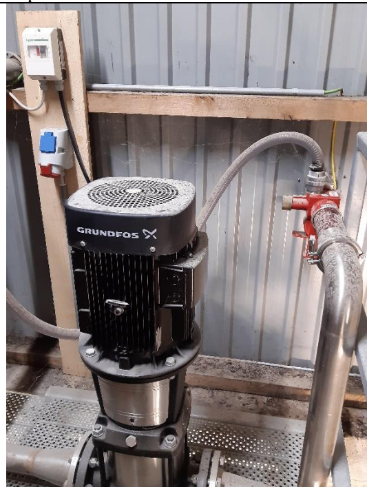
Foto 8: Pumpe, der anvendes i forbindelse med skumtilførsel til brandslukningsvand. Pumpen betjenes manuelt.
