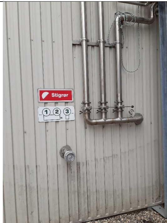
Foto 6: Stigrør til fremføring af slukningsvand til de 3 siloer. Installationen er placeret ved silo 2.
