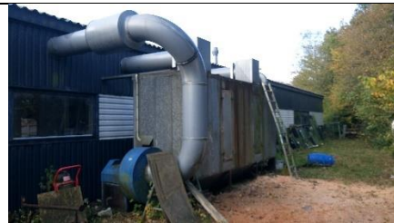
Billede nr. 4 – Posefilteranlæg ved den "nye" afdeling. (2021)
