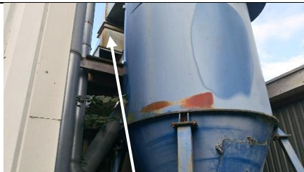
Billede nr. 3 – Luften fra posefilteret afkastes vandret. (2021)
