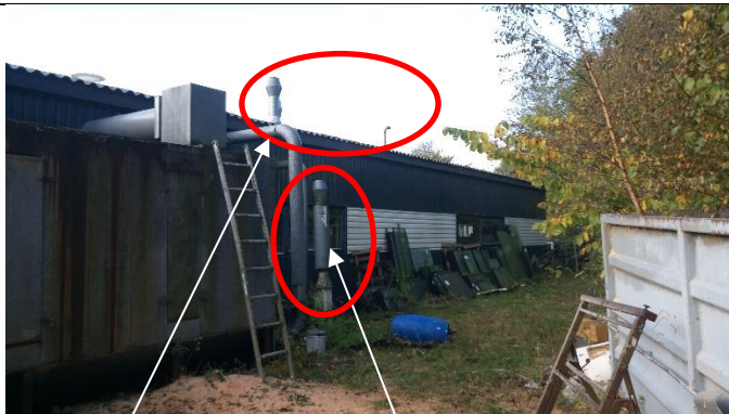
Billede nr. 8 – Afkast fra undertrykssug ved bredbåndspudseren (benyttes aldrig), de 2 afkast er demonteret indendørs.
