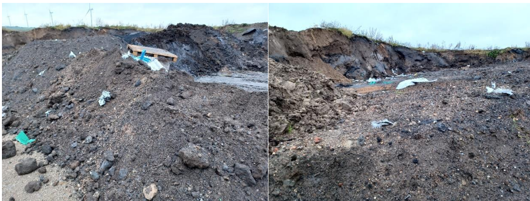
Figur 14: Afgravede dele af enhed 10 indeholdende asbest .
