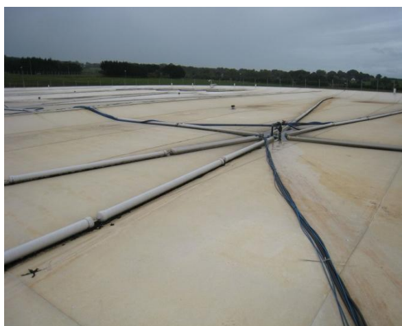
Foto 2: Tanken set fra oven med flydende overdækning for opsamling af biogas
