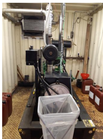
Fig. 2 Gasmotor i lukket container
