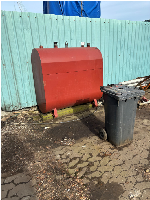
Figur 2. Olietank står på sf-belægning med en gummislange tilsluttet oliefyret i værkstedet. Der er tegn på oliespild på belægningen.
