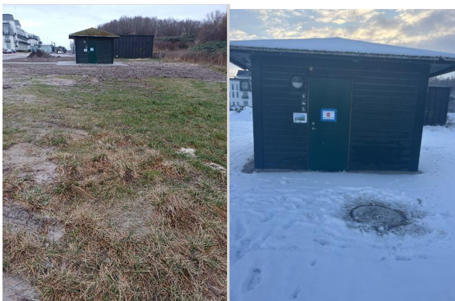
Det var på tilsyn ikke muligt at lokalisere boring 5. Der er efterfølgende fremsendt billede med placering, th.
