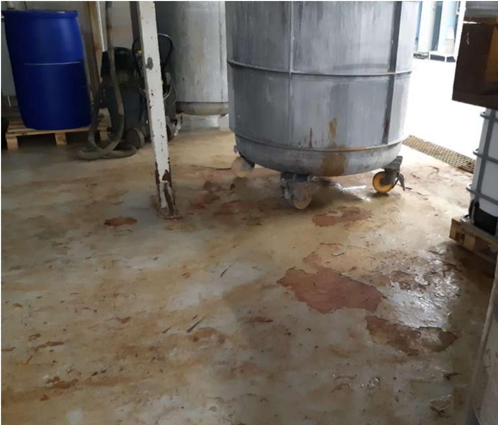
Foto gulv, Oldenvej 15, der skal udbedres
