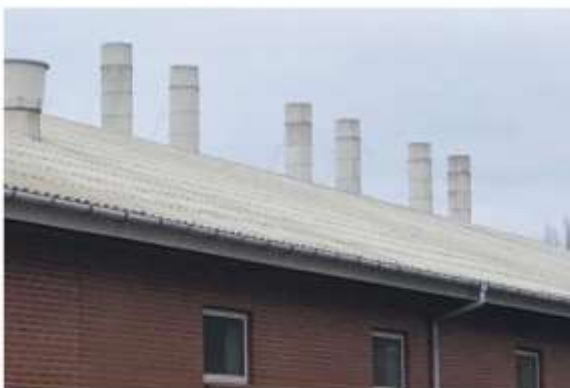
Eksempel på forhøjede ventilationsafkast
