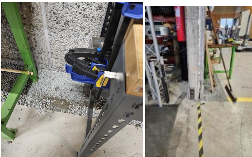
Foto 1a-b: jord og grus langs væggen mellem maskinværkstedet og lageret.
