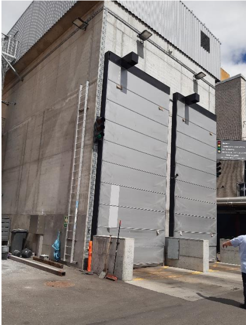
Silo til madaffald. Portene var ved tilsynet lukkede.
