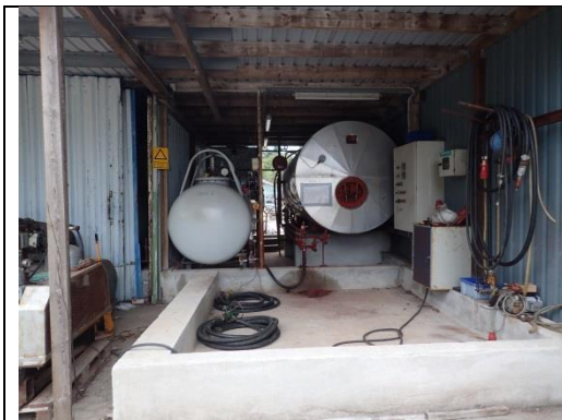
Billede nr. 1: Ammoniakanlæg (2016)
